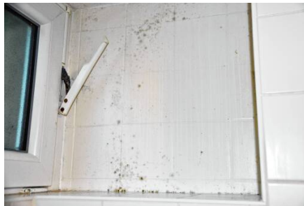
Maximilian Reinhardt. Schimmel an der Decke (Bild oben) und an der Wand (Bild unten) auf dem Jungen-WC an der Gemeinschaftsschule Goldberg. Bild: z Bilder: Krauter
