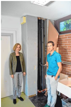
Das Schulleitungsteam Diemut Rebmann und Hannes Weber vor der Stelle im Kunstraum der Gemeinschaftsschule Goldberg, wo die löchrigen Wasserleitungen erneuert wurden.
